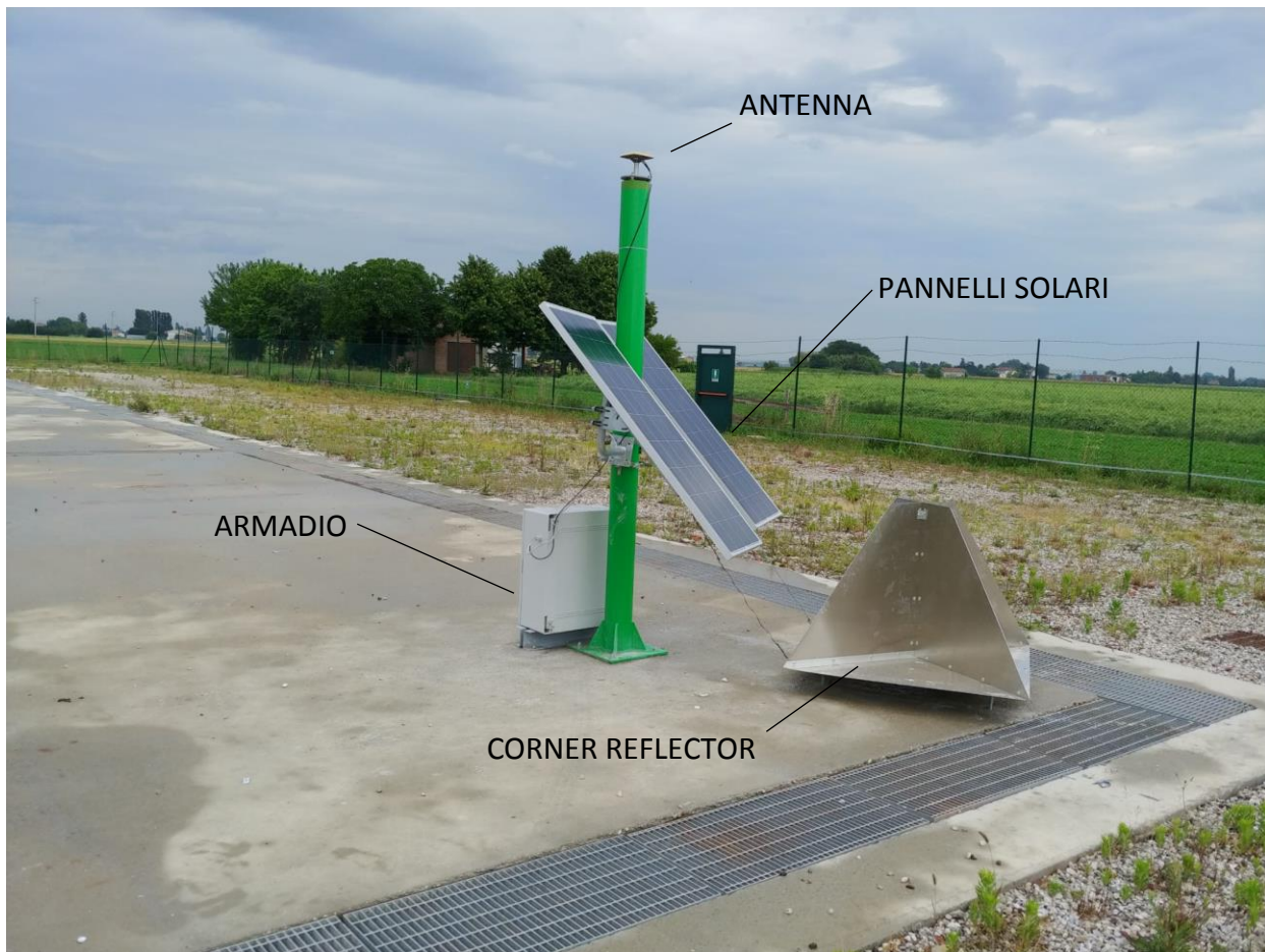
Figura 34 – Stazione GNSS e corner reflector installati presso area pozzo
